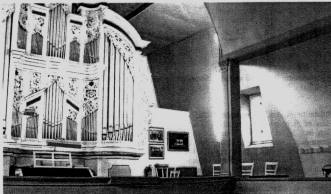
Die Orgel in der 1747 erbauten Kirche ist von einem Pilz befallen und bedarf ebenfalls der Sanierung. Fotos (2): Matthias Voigt
