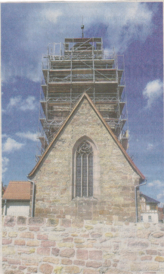
Arbeiter hantieren in dieser Woche auf dem Gerüst an der Kirche in Heilingen. Foto: Thomas Spanier
